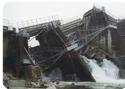
921大地震石岡壩受損
